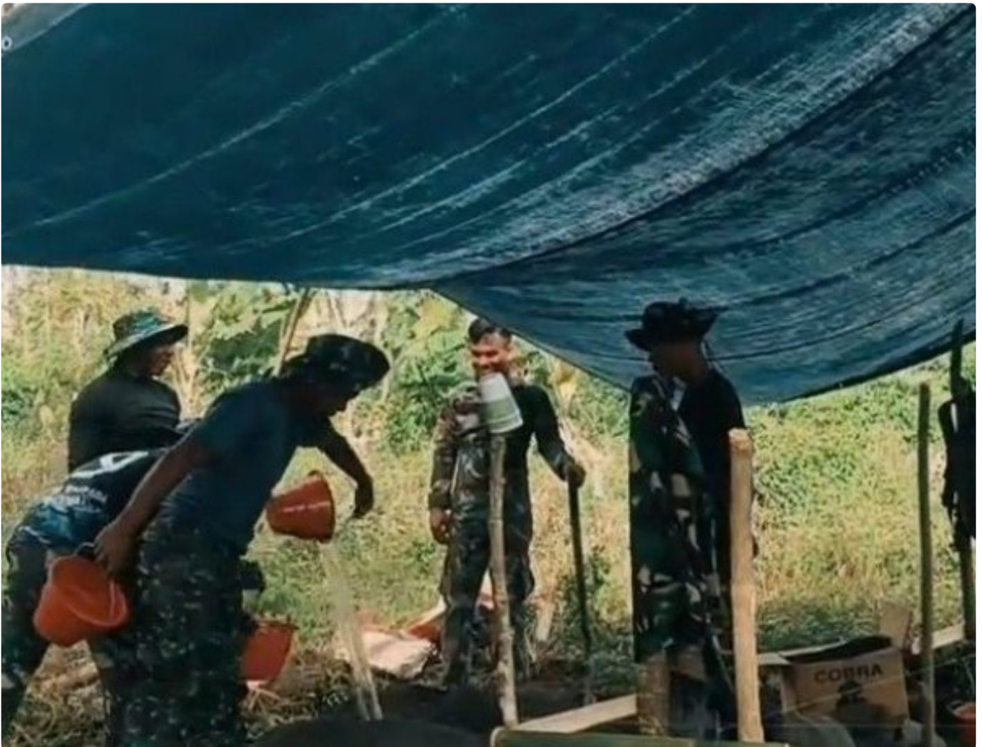
Pekerjaan Pembangunan Bak Penampung Air Bersih oleh Tim Work Satgas TMMD Ke-123 Kodim 1310 Bitung
